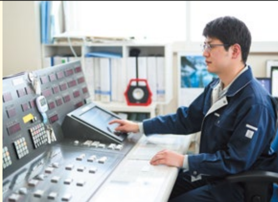
ダムを管理するための専用機械を操作。
