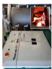
＜木質バイオマスボイラー＞
