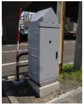
信号機電源付加装置 (札幌市)
