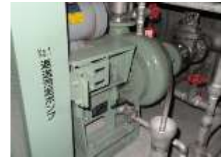
漁業集落排水処理施設の機器更新 (上ノ国町)
