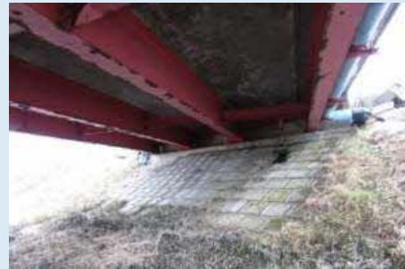
橋梁の老朽化
