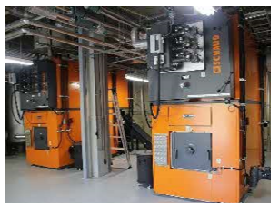
(木質バイオマスボイラー)
