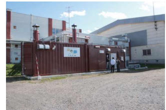
木質バイオマスボイラーなどの設備は、コンテナ内に設置している。
