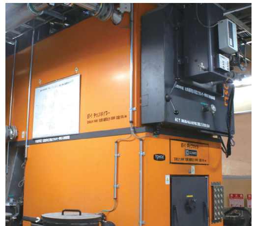
導入からもうすぐ9年が経過するボイラー。
