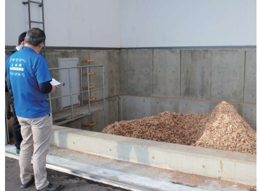
チップ保管庫は地下に保管する形になっている。
