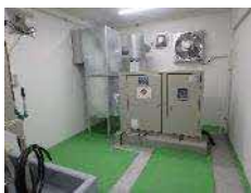
非常用発電機の設置
