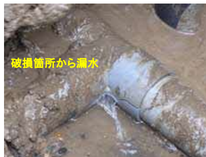
整備前(老朽化した管路)
