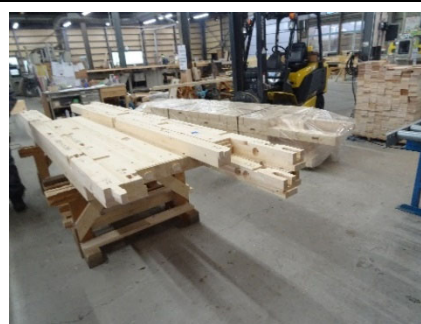
プレカット設備
