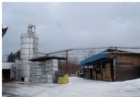
本社工場 木質バイオマスボイラー
