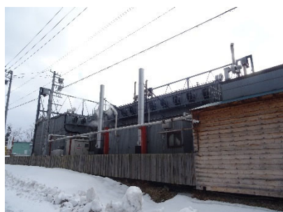
蒸気木材乾燥施設
