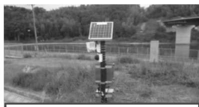
太陽光パネル・Webカメラ
