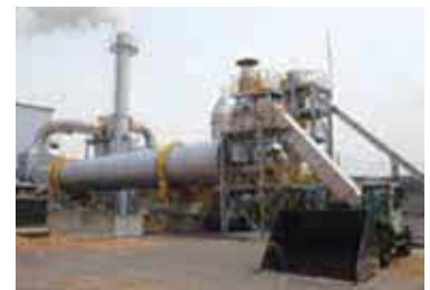
【バイオマス発電プラント】
