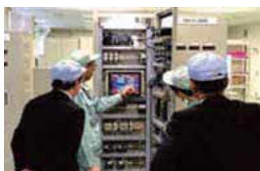
【ダム監視盤試験風景】
