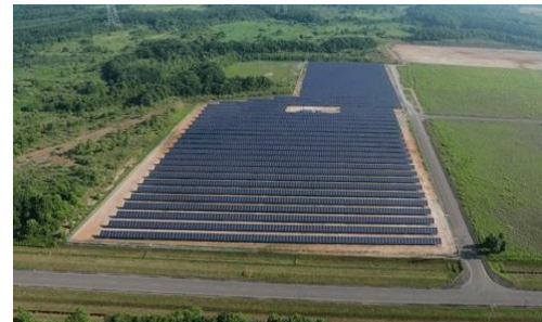
▲ シャープ苫小牧第一太陽光発電所 (出典：シャープ)
