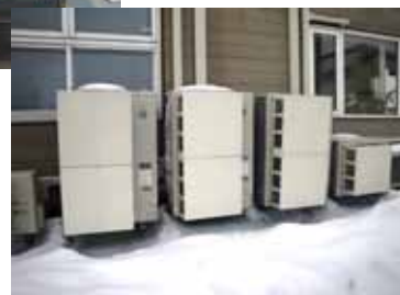
ヒートポンプ
