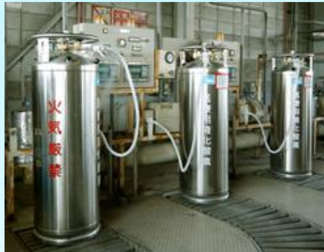
LGC充填設備
