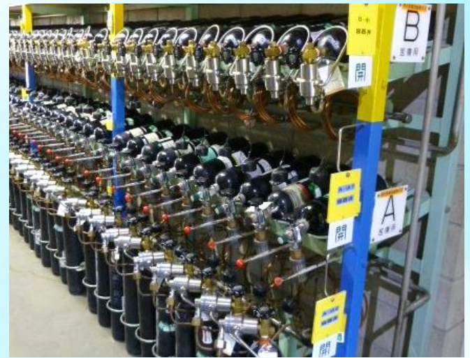
シリンダー(在宅酸素容器)充填設備
