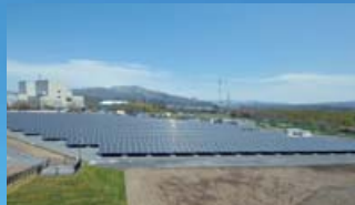
伊達ソーラー発電所 (伊達市)
