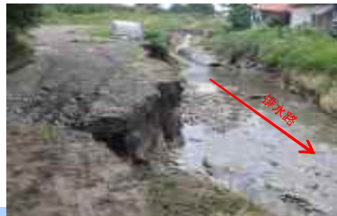
清水町：排水路の被災（護岸の流失）
