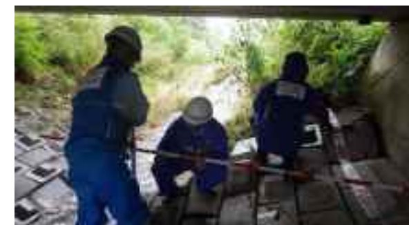
関東地整道路班 中央11号橋被災状況調査(清水町)
