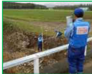
サラベツ川 河岸洗掘 (中札内村)
