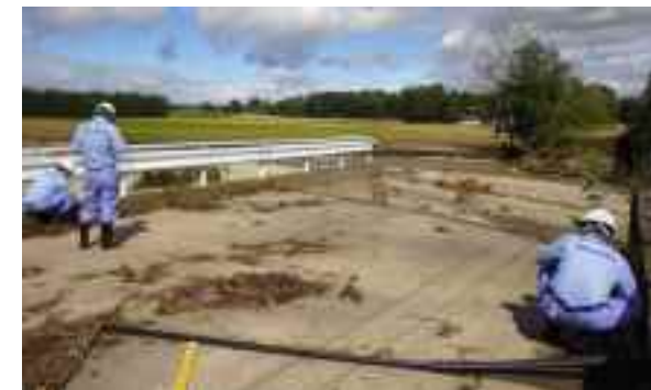
関東地整道路班 旭橋被災状況調査(清水町)
