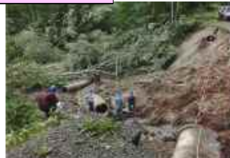
上富良野町：用水路の被災（地盤崩落による管水路の破損）
