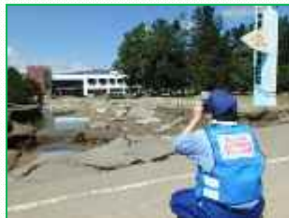
役場敷地内道路の損傷 (南富良野町)
