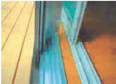
入居者が設置したスノコによる段差解消の例
