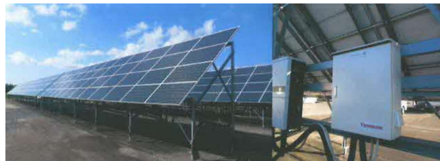
製材工場での導入写真 (太陽光発電出力350 kW)
