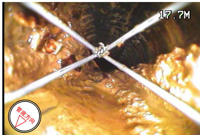
暗渠管内の土砂堆積状況
