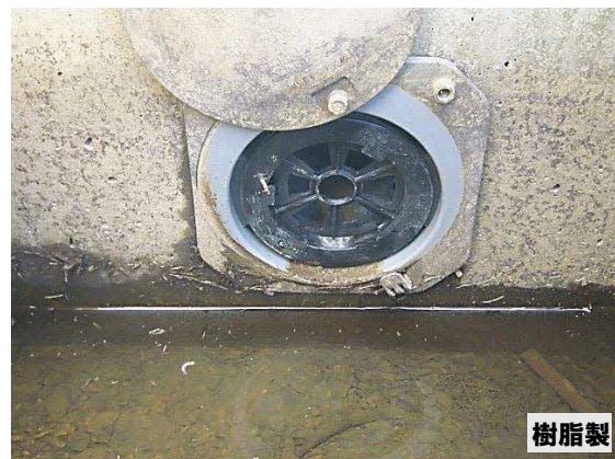
流入口埋め込み式（スクリーン）
