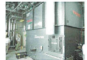
バイオマスボイラー
