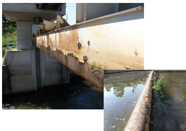
(堰) 洪水吐、土砂吐ゲートの腐食
