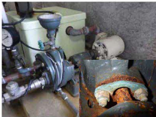
(排水機場) 真空ポンプにおける回転不良
