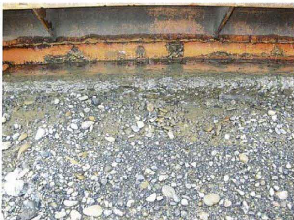
(堰) 転倒ゲート下部戸当りの腐食
