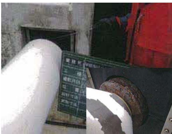
(防潮水門) 連動軸の継手における塗装腐食
