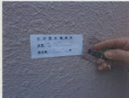
ひび割れ計測 Y4通 X1～X2間 (外壁)
