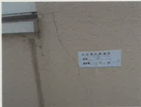
ひび割れ計測 Y4通 X8-X9間 (外壁)
