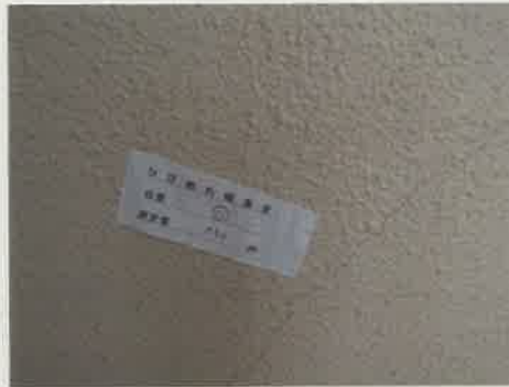
ひび割れ計測 Y3通 X4付近 (外壁)
