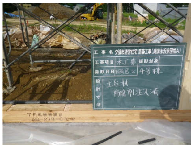
写真 2.5 保存処理(防腐剤注入)された土台
