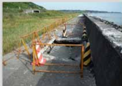
海岸堤防の老朽化状況
