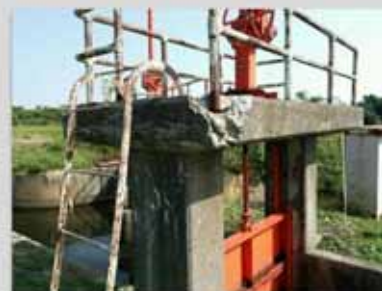
用水路（取水ゲート）の破損状況
