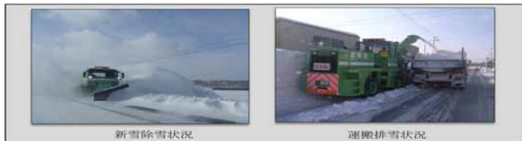
図14 道道の除排雪状況
