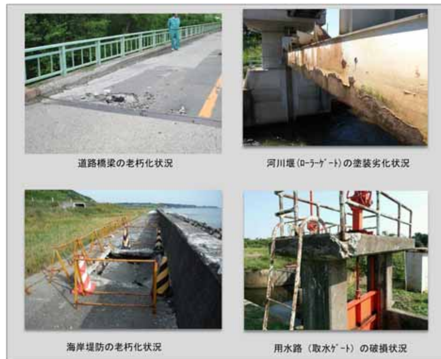
図6 道が管理するインフラの老朽化状況
