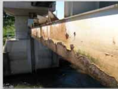
河川堰（ローゲート）の塗装劣化状況
