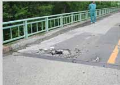
道路橋梁の老朽化状況
