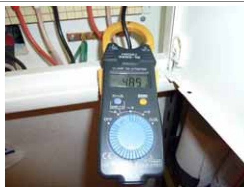
4. EV車へ充電されている電流量 (4.8A)
