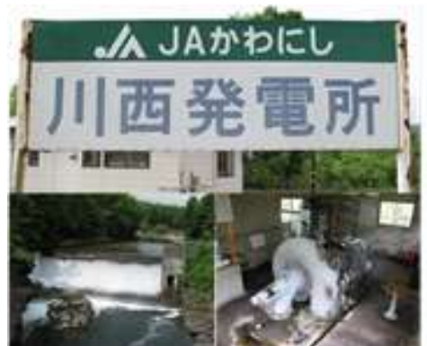
十勝管内川西町でJAが運営する小水力発電所 (出力 160kw)
