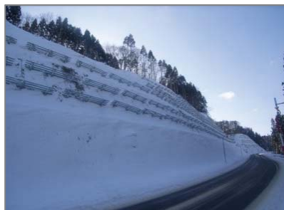
<対策例>雪崩予防柵
