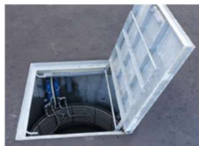
融雪槽内に地中熱ヒートポンプの採熱コイルが設置されています
