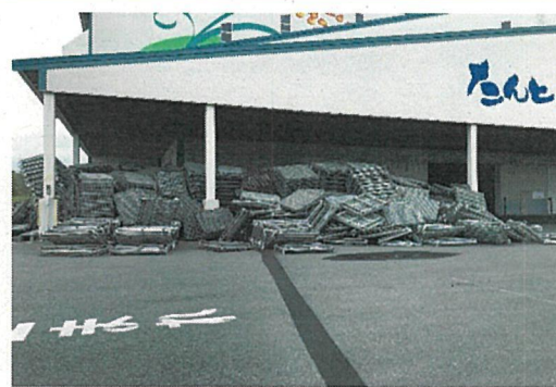
米乾燥調製施設の損壊(地盤沈下)
