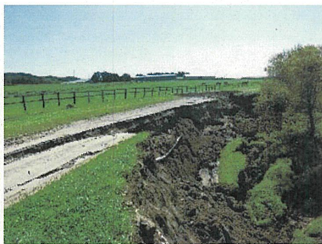
農道や用水路(パイプライン)の損壊
