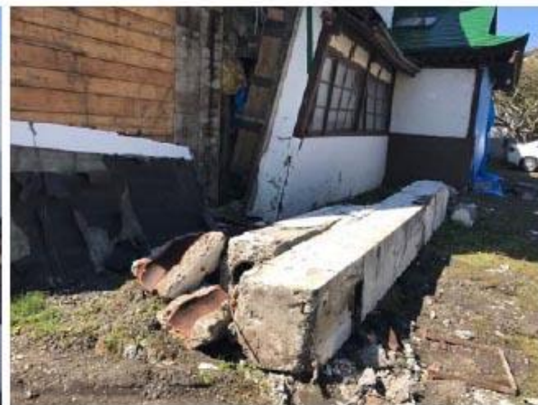
(c) 倒壊した煙突
