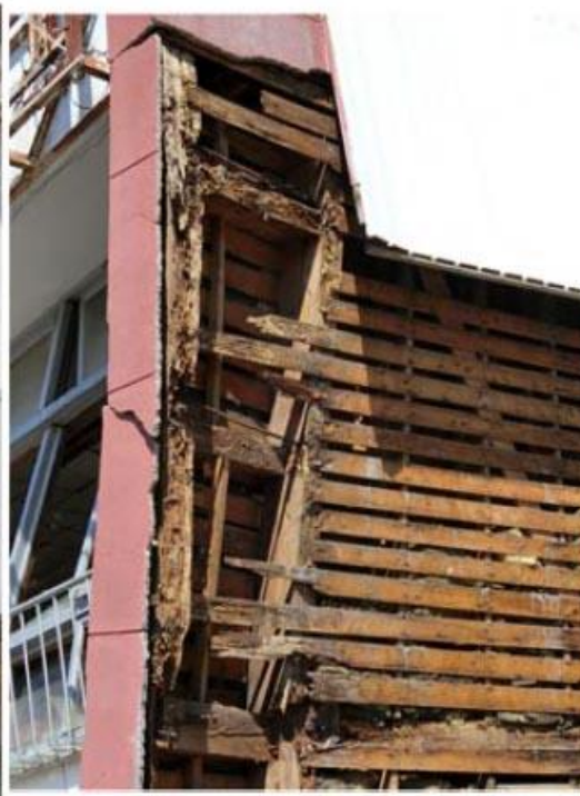
(f) 柱等の腐朽・蟻害
