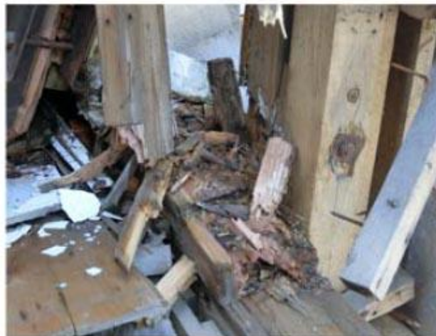
(e) 柱脚部の腐朽
