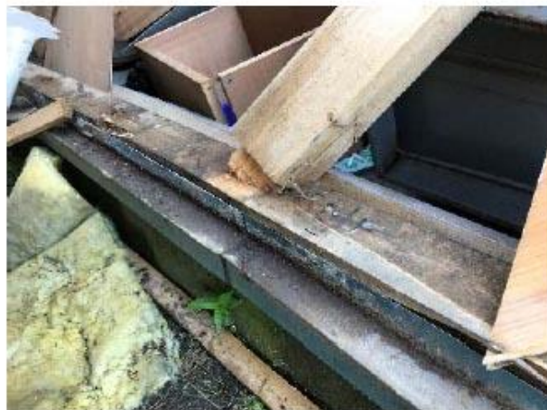
(e) 柱脚の短ほぞ 写真 5.1.9 建築物 8 の被害状況
