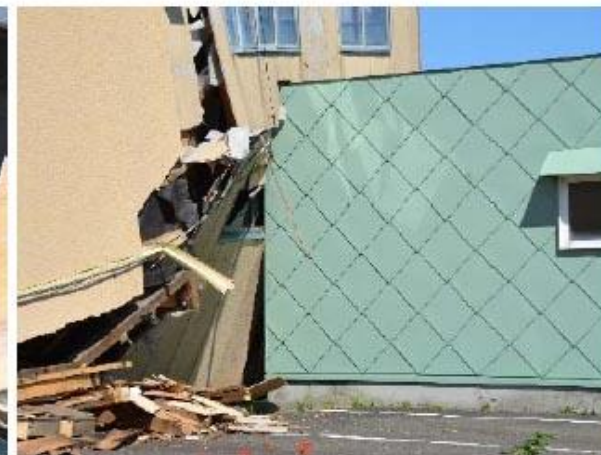
(f) 隣接建築物との衝突部分
