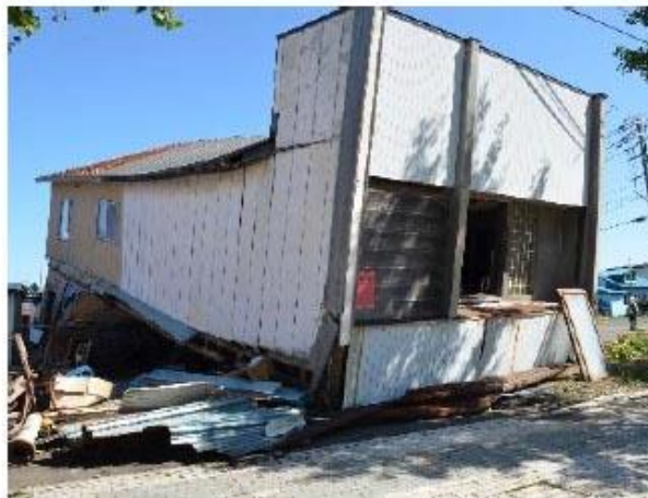
(b) 2階が東側へ倒れた正面 部分
