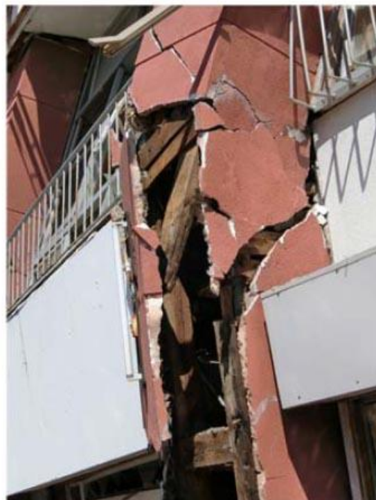
(e) 4 本柱の折損
