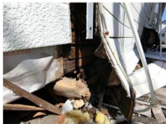
(d) 一部の構造躯体の腐朽
