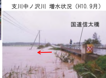
支川中ノ沢川 増水状況 (H10. 9月)
