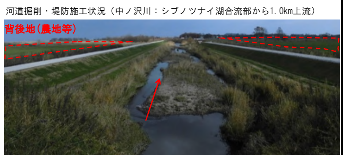
河道掘削・堤防施工状況 (中ノ沢川：シブノツナイ湖合流部から1.0km上流)
