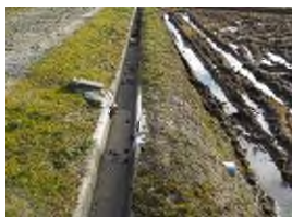
用水路からの漏水状況
