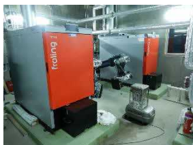
木質バイオマスボイラー: Fröling社製130kW × 2基
