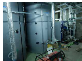
蓄熱タンク: 容量4000L × 2基
