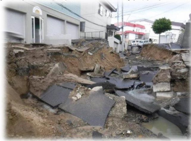
札幌市清田区（道路損壊）
