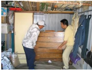
倉庫床下の巣の除去の様子
