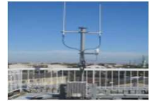
通信施設の整備
