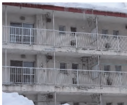
公営住宅の老朽化
