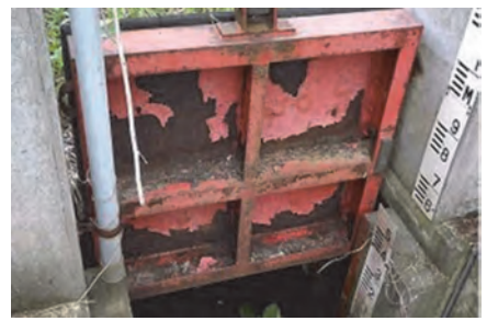
樋門ゲートの腐食
