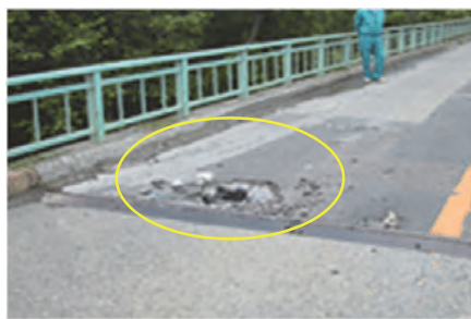
橋梁床版の抜け落ち
