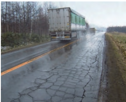
道路の舗装の劣化
