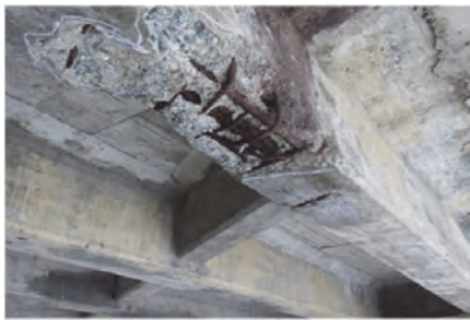
橋梁主桁の劣化
