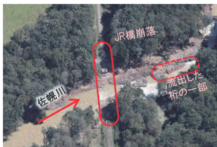
平成28年8月台風の被害状況 JR橋の崩落 (第1佐幌川橋梁)
