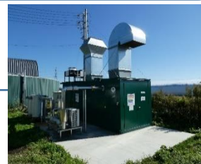
▲ バイオマス発電設備 (メタン発酵ガス)
