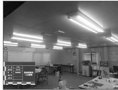
現場事務所におけるLED蛍光灯の使用
