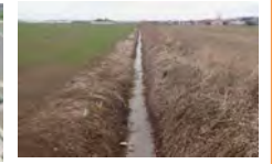
排水路の切深不足
