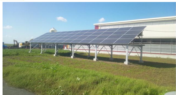
中山間浜中・別寒辺牛集落における太陽光発電設備
