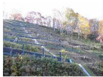
留萌南町 4 丁目2 急傾斜地崩壊防止施設 (留萌市)
