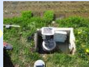
設置された自動給水栓
