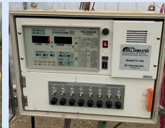
自動巻き上げ機の制御盤 (モーター8個制御)
