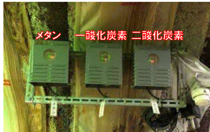
地下の環境を監視するセンサー
