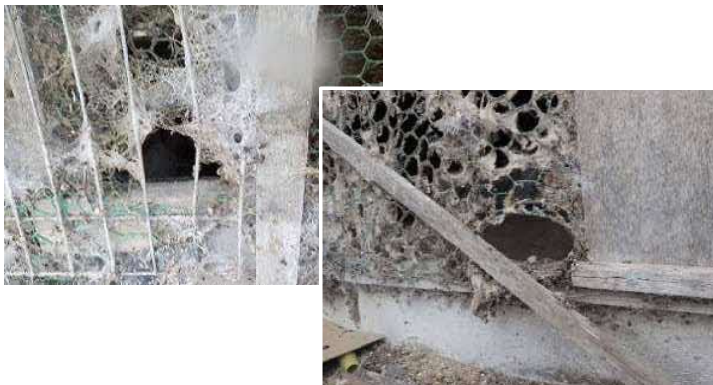
鶏舎開口部の金網の破損・湾曲
