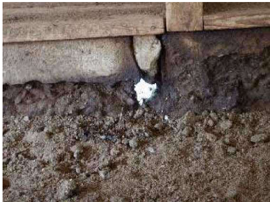
鶏舎基部の隙間
