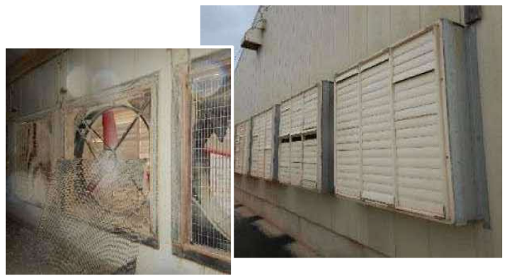
排気ファンの金網脱落・シャッター破損
