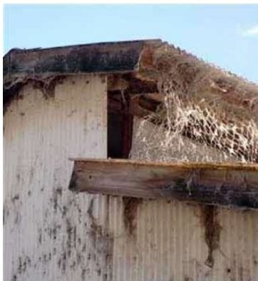
防鳥ネットの破れと鶏舎の壁の破損
