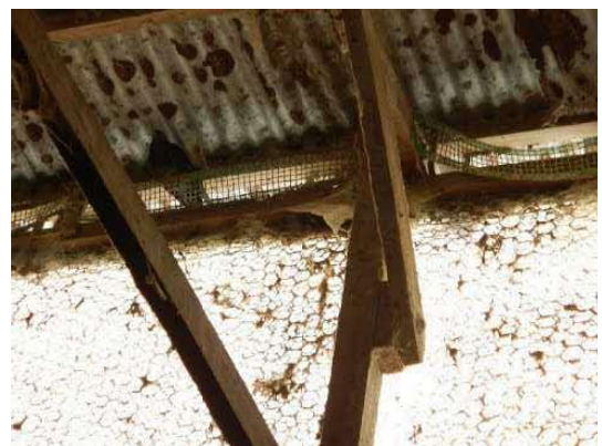
鶏舎のモニター式屋根の隙間から侵入したハト
