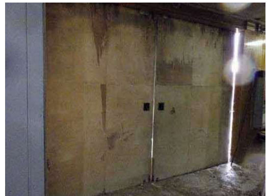
鶏舎外側出荷用出入口扉の隙間
