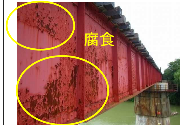
腐食が発生した橋りょう
