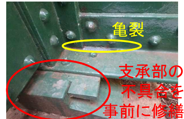
亀裂が発生した橋りょう
